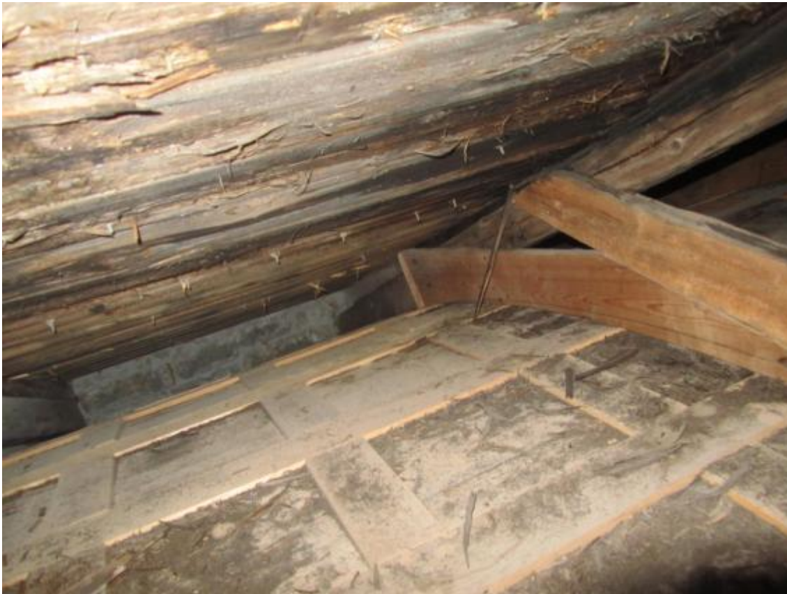
Mynd 3 Sperruendar sem ganga út í útveggir virðast óskemmdir sé úr þakinu.
