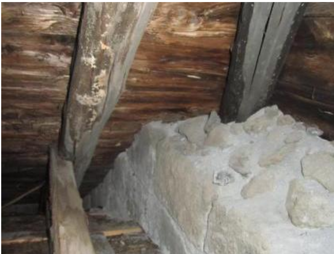
Mynd 4 Sperra næst austurstafni og gratsperur eru fúnar sem og þakklæðning.
