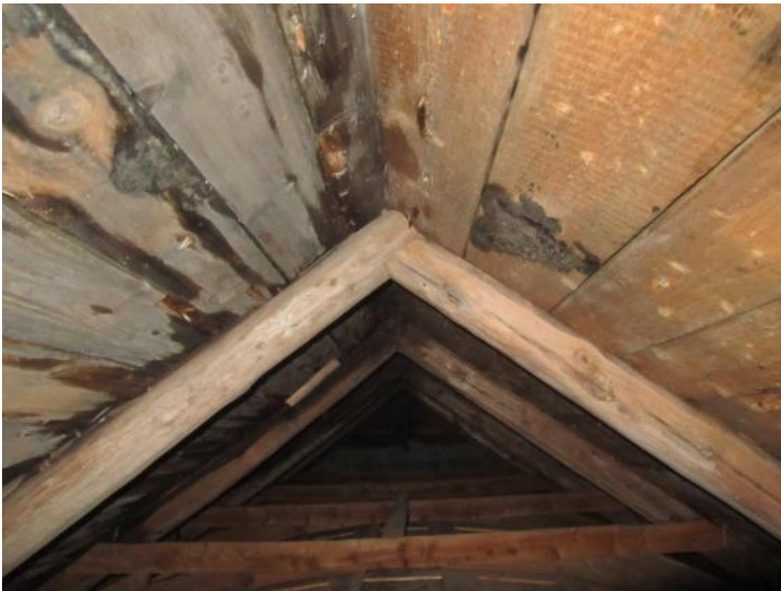
Mynd 1 Horft inn eftir þaki úr lúgu á sönglofti. Fúaskemmdir eru í þakklæðningu norðan við mæni.
